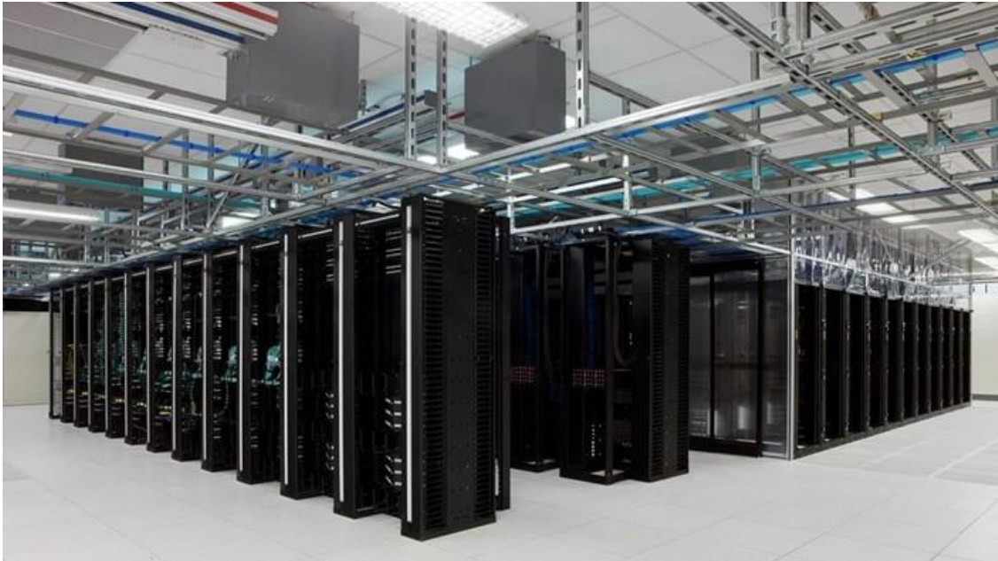
Figura 2. Sala de datos de un centro de datos
