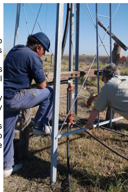
Sistema sostenible de extracción de agua
