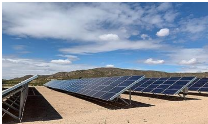
Imagen 9: Planta solar fotovoltaica Herrada del Manco (Murcia) [7]
